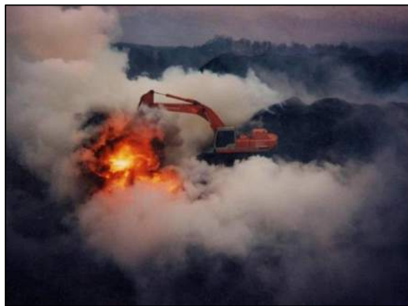
Figure 21 : Défournement de matériaux en combustion (réalisation d'une tranchée coupe-feu) - Terril de Ronchamp (Haute-Saône, 70) (collection Y. Paquette, issu de [28])
